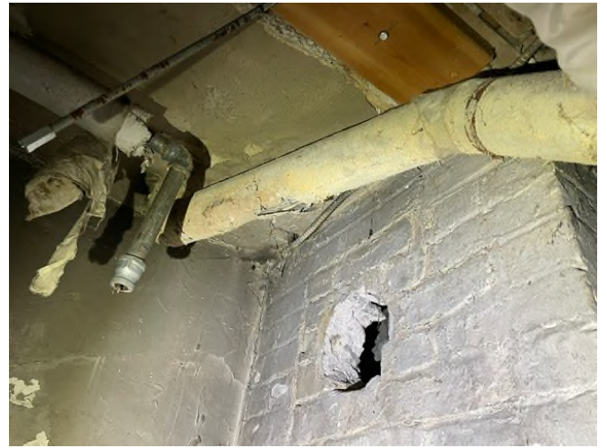
Asbestos wrapped pipes
